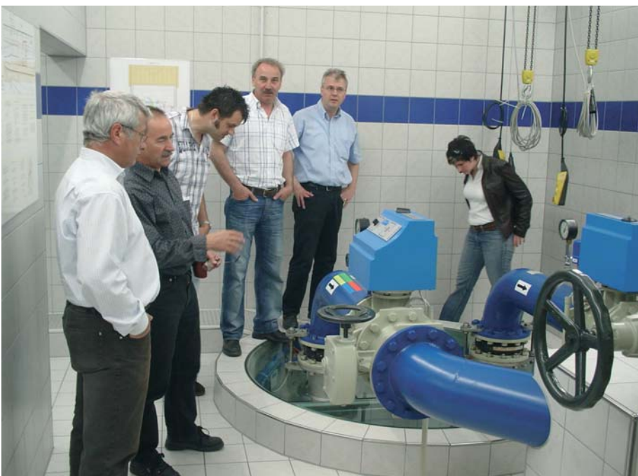
Toni Pfeiffer von der WLU erklärt das Pumpwerk Oberau.
