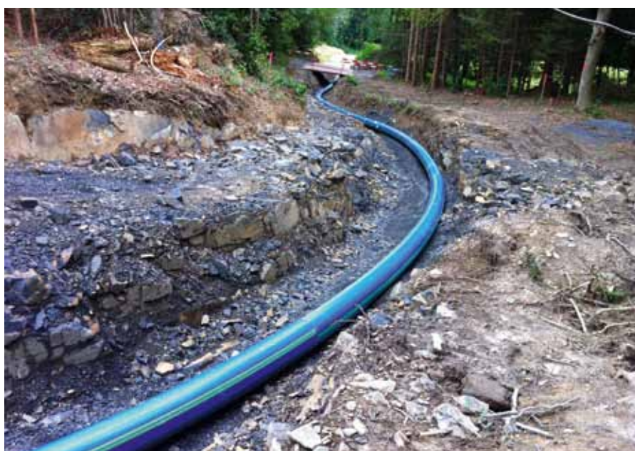
Die Kunststoff-Wasserleitung, mit einem Durchmesser von 257 mm mit Schutzmantel, im Bereich "Studa" – Zufahrt zum Reservoir.
