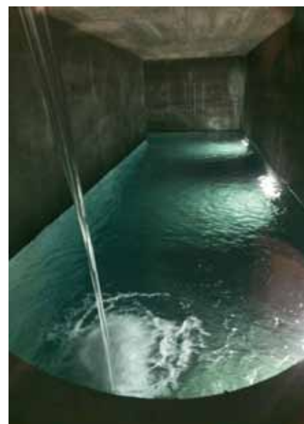
Blick in die Behälterkammer beim neuen WLU-Reservoir in Ruggell.
