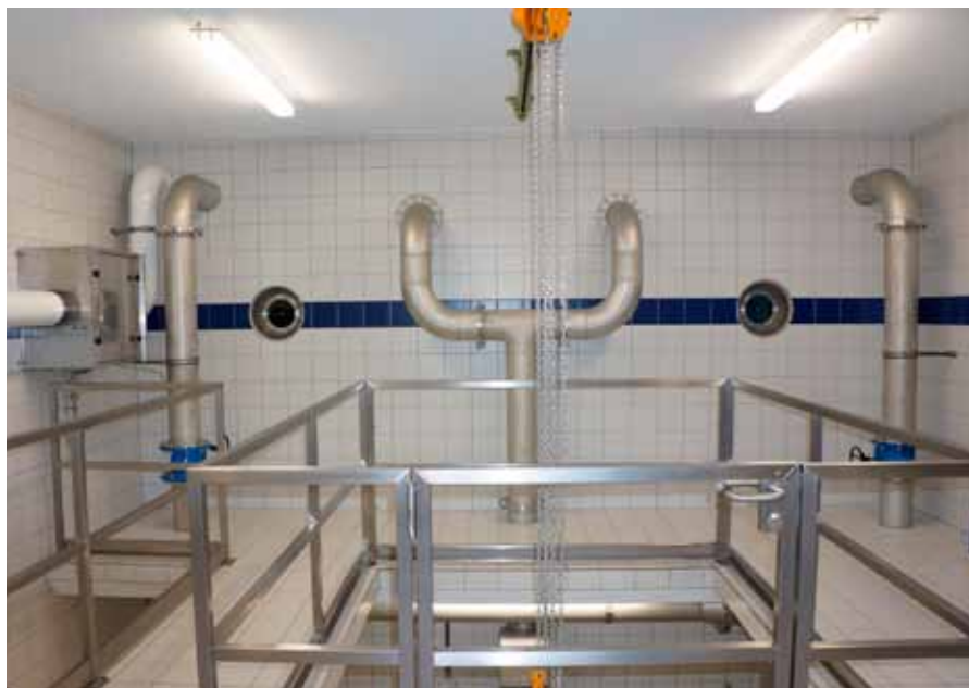
Die Vorkammer des neuen WLU-Reservoirs in Ruggell.
